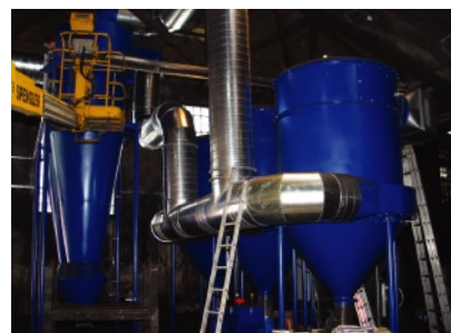
Absauganlage bestehend aus Filterzyklone und Doppelhochleistungszyklone.
