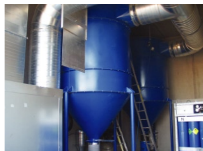
Zwei Filterzyklone und ein schalldämmter Radialventilator mit einem Nennvolumenstrom von 45.000 m 3 /h.
